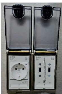
Steckdose und EDV-Anschluss im Isolator-Nutzerraum
