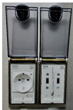
Steckdose und EDV-Anschluss im Isolator-Nutzraum
